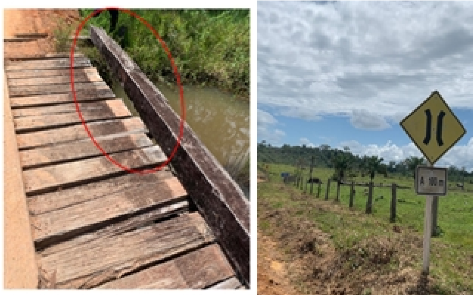
Figura 5.10: Ponte com barreira rígida empenada (A), placa de advertência para ponte estreita com sua respectiva distância (B).
