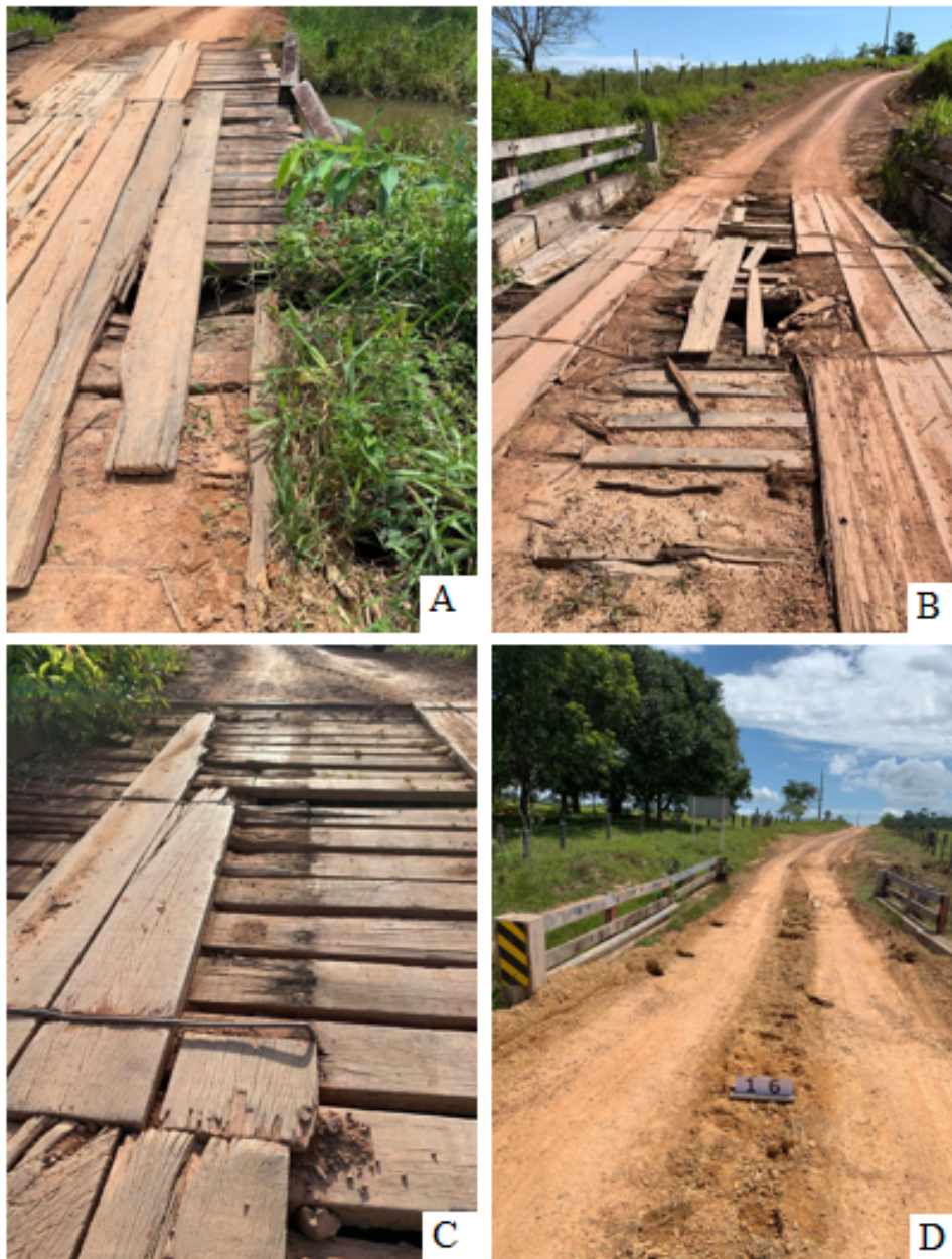
Figura 5.9: Pontes com tabuas soltas (A), espaçadas (B), rachadas (C) e cobertas por solo (D).
