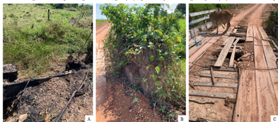
Figura 5.8: Registro de passagem de fogo (A), presença de vegetação (B) e bovino na ponte (C).
