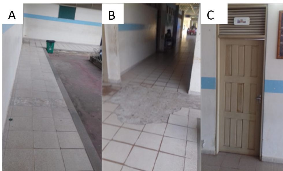
Figura 3: A) Corredor da escola. B) Piso da escola pesquisada. C) Largura das portas.
