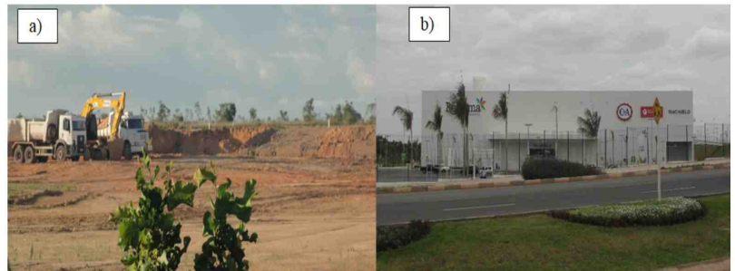
Figura 4: a) início da terraplanagem da área, julho de 2012. b) Shopping em funcionamento, dezembro de 2014.
