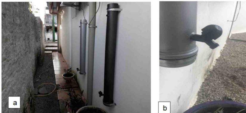
Figura 03: a) vista parcial dos reservatórios instalados no hostel; b) reuso da água captada.
